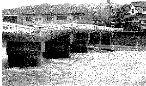
通行止めが続く徳瀬橋、災害直後
