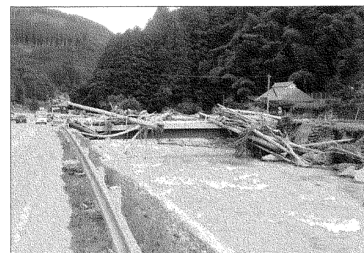
上の写真は、小野鈴連町の県道に架かる外園橋で止まった流木。
