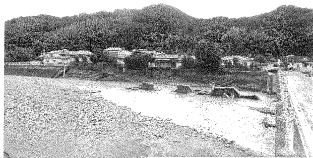
夜明上町中楚地区、右の中楚橋の護岸から住宅前の市道(夜明・大鶴線)が100数十m完全崩落。
